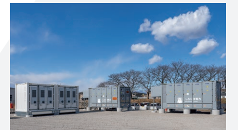
太田市亀岡町蓄電システム
