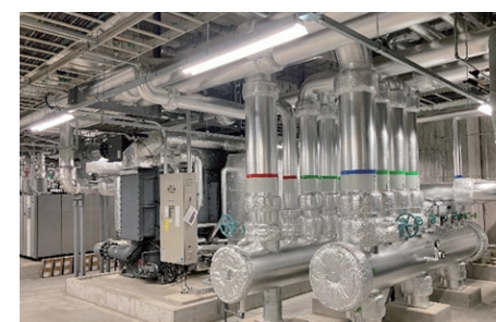
福岡大学病院本館ES事業機械室
