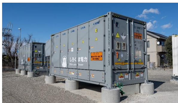
案件名：太田市新田赤堀町蓄電システム 所在地：群馬県太田市新田赤堀町 出力：2MW 蓄電池システム：CATL
