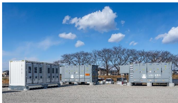
案件名：太田市亀岡町蓄電システム 所在地：群馬県太田市亀岡町 出力：2MW 蓄電池システム：CATL
